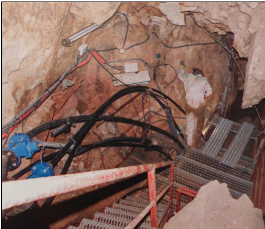
Captage dans le Puits des Racines pour l'alimentation en eau de Villefranche-de-Conflent (J. M. Victoria).
